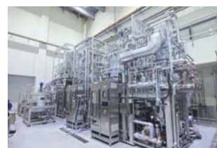
パイロット設備の一部
