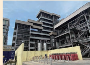
増強した酵素エステル交換設備
